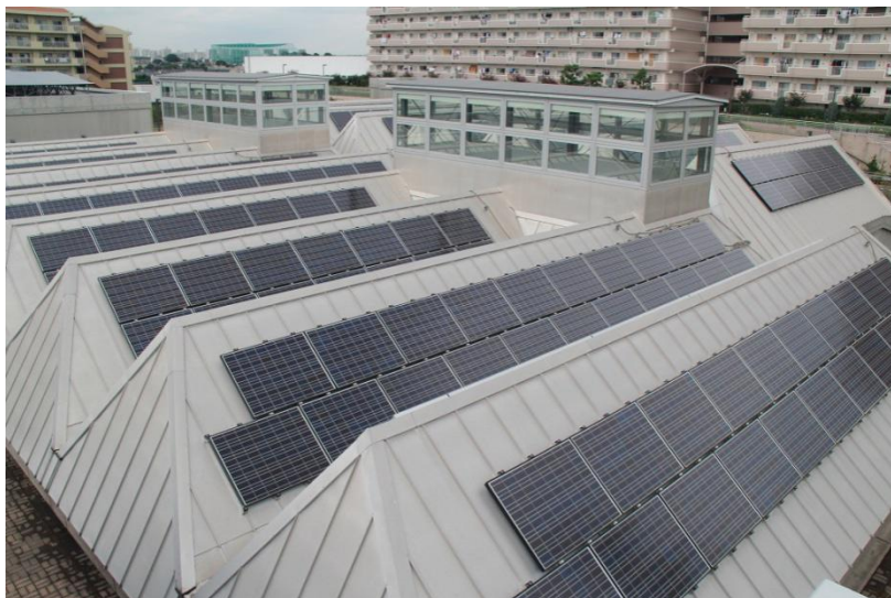
太陽光発電システム (市役所屋上)
