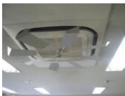
省エネ型空調機
