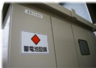
蓄電システム
