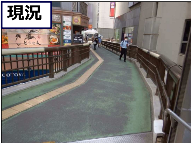
舗装の摩耗・ひび割れがみられる
