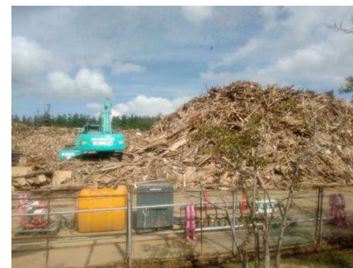
輪島市仮置き場の様子
