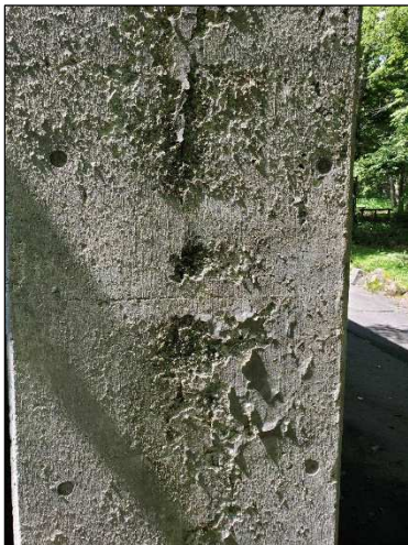
体育館・外壁の劣化
