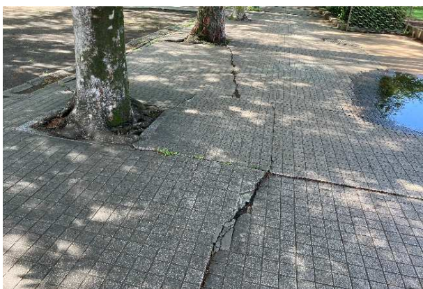
不陸等による園路のひび割れ・段差
