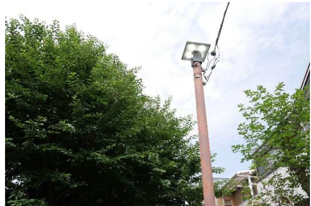
昼間も点灯している照明灯
