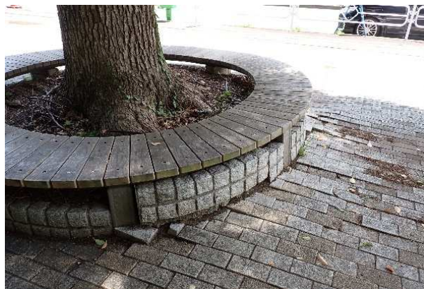
サークルベンチの劣化(石材剥離、座部木材)
