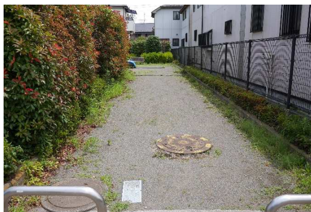
マンホール蓋部に段差が生じる広場
